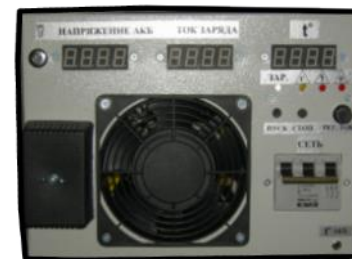
Передняя панель зарядного устройства УЗИ 48/60
